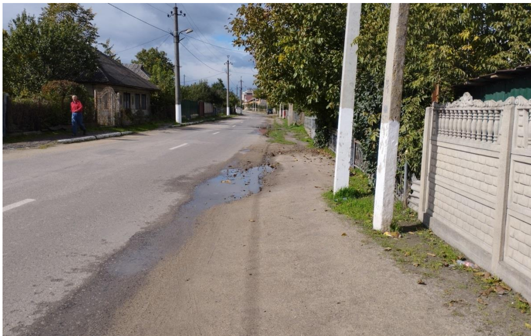
Starea trotuarelor din str. Ștefan cel Mare
